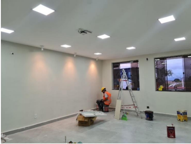
Foto 37 – Instalação elétrica - Sala
