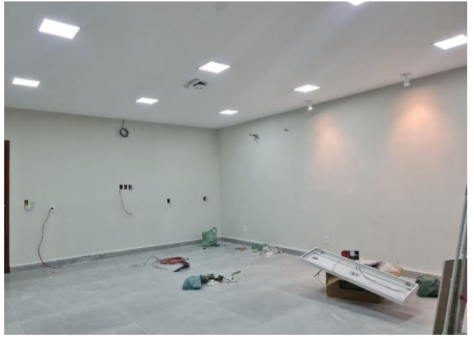
Foto 38 - Instalação elétrica - Sala
