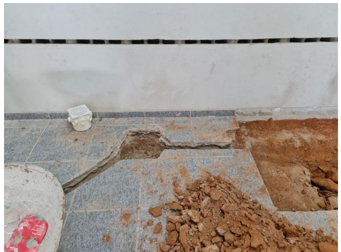
Foto 72 - Infraestrutura hidráulica banheiro
