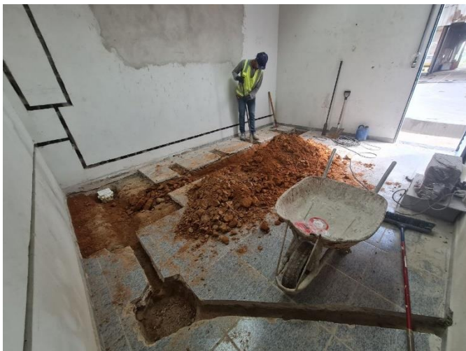
Foto 71 – Infraestrutura hidráulica banheiro
